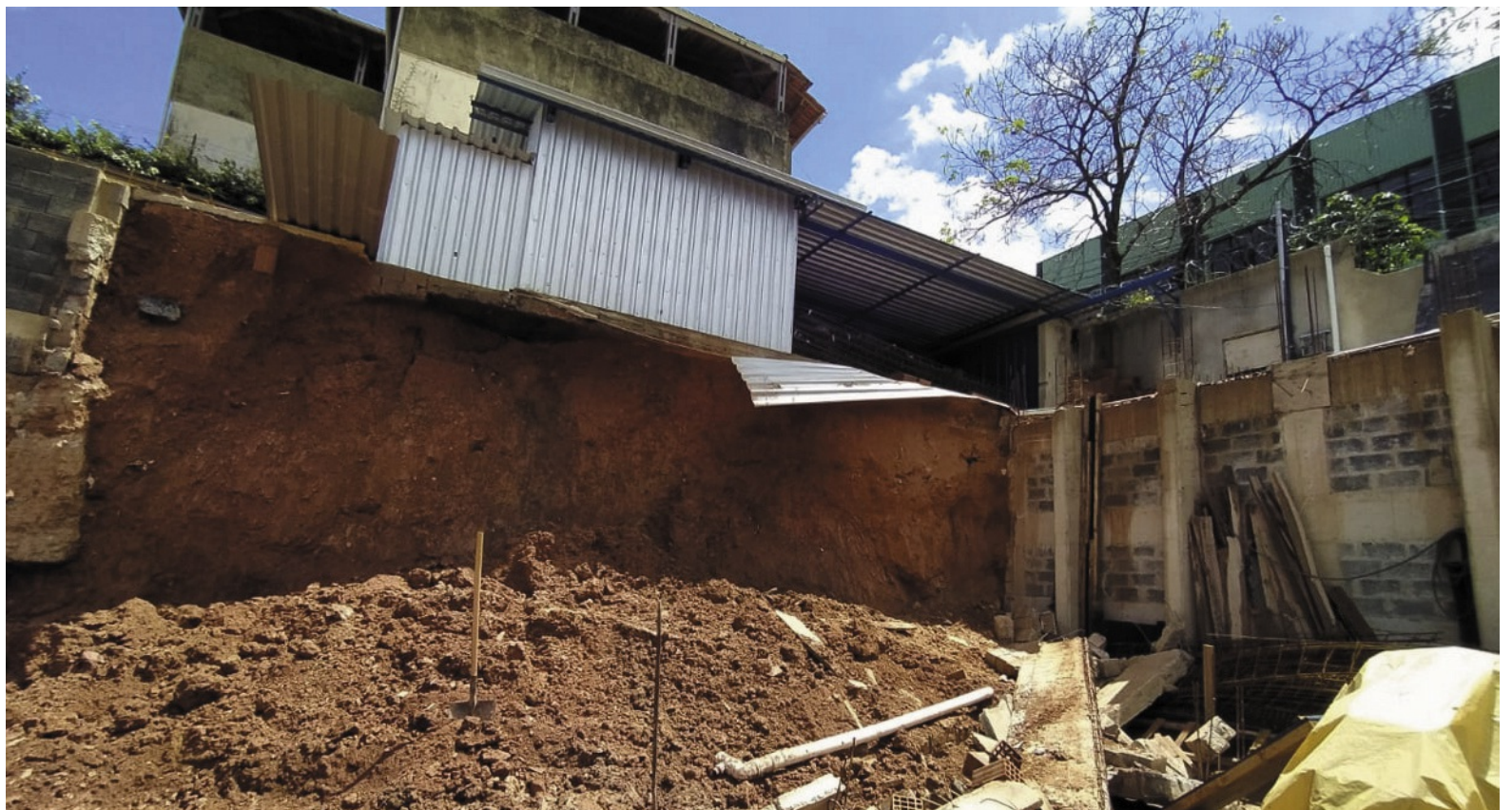
| AMEAÇA- Muro de contenção desabou em obra no bairro Serra, Centro-Sul de BH, e o responsável foi orientado e notificado a apresentar um plano emergencial |
